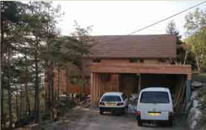
Accès latéral, par le haut, parallèlement aux courbes de niveau. On peut remarquer la réalisation du soutènement des talus créés.
