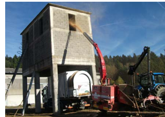
Premier silo de plaquettes
