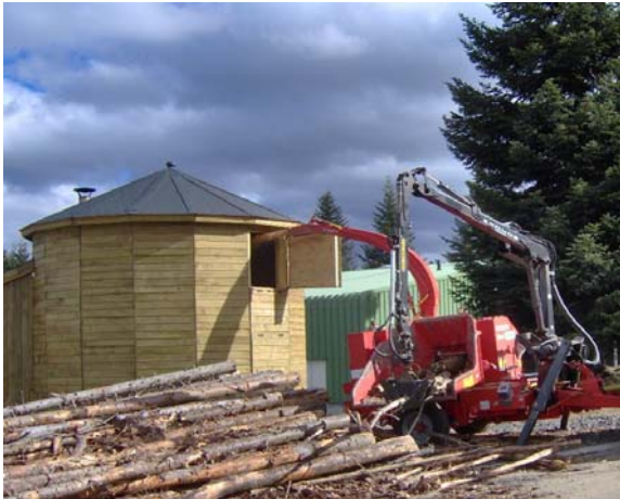
Broyage direct avec un tas de bois à côté de la chaufferie
