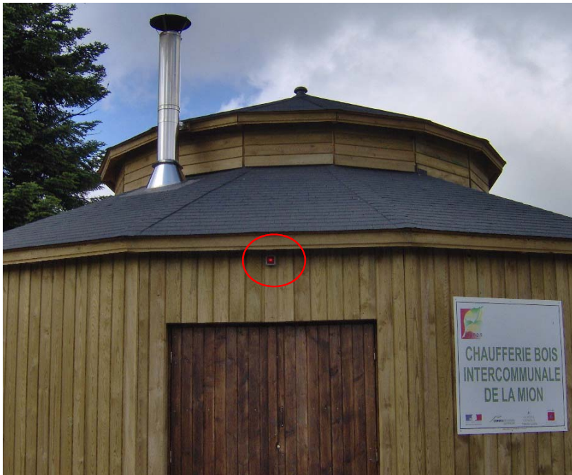
Suivi par le client principal + voyant défaut
