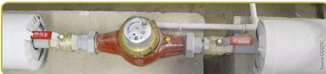
Vannes d'isolement en amont et en aval, compteur placé dans un point bas, à l'horizontale
