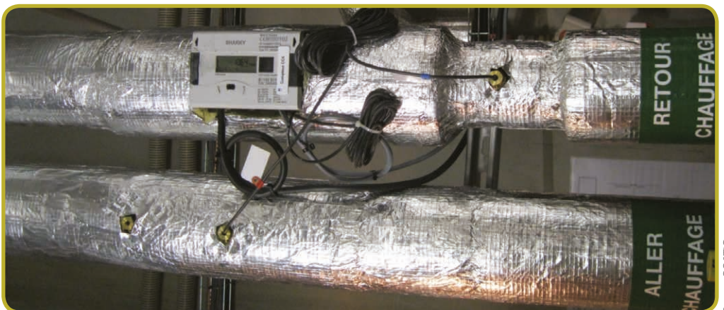
Compteur d'eau sur le retour, longueurs droites suffisantes, doigt de gant doublé pour comparer les sondes de températures
