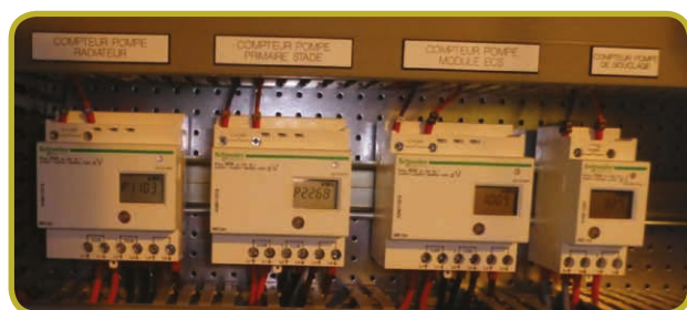
Compteurs électriques sur rails DIN, explicitement libellés
