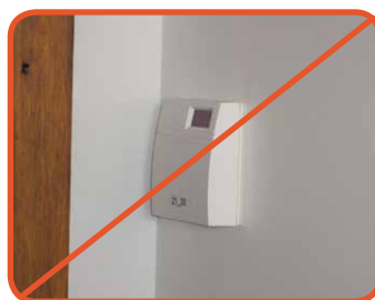
La sonde est dans un coin de la pièce et partiellement masquée par un meuble
